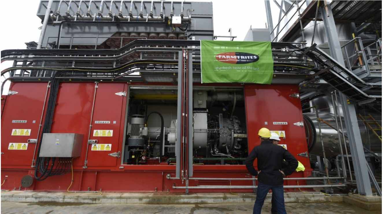
Callens bouwt installaties voor onder andere proceswarmte, ventilatie, koeling en luchtafzuiging voor de industrie. ©Photo News
